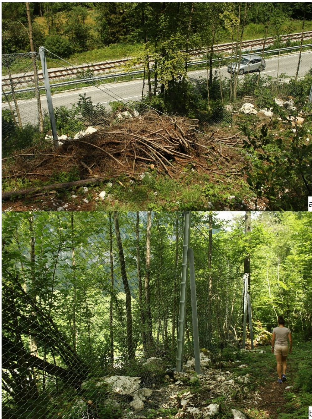
Slika 6 a in b: Mreža za varovanje cestnega in železniškega odseka pred valjenjem skal v gozdu na spodnjem delu mrazišča (foto: S. Povhe).
